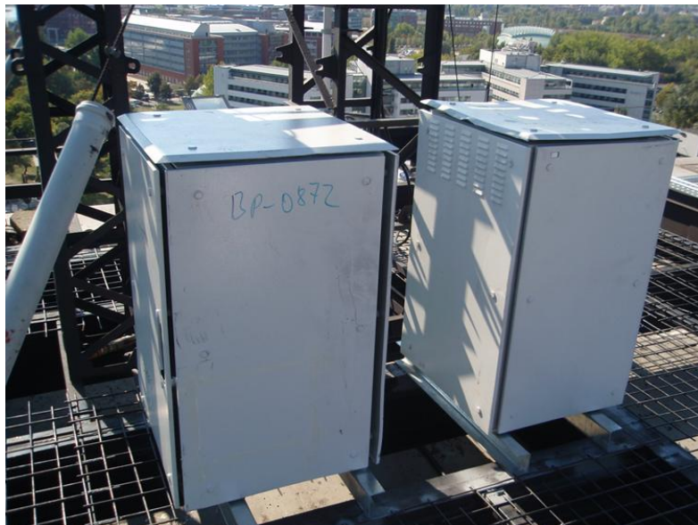
15. ábra A RF rack szekrények az antennarendszer talppontjában
